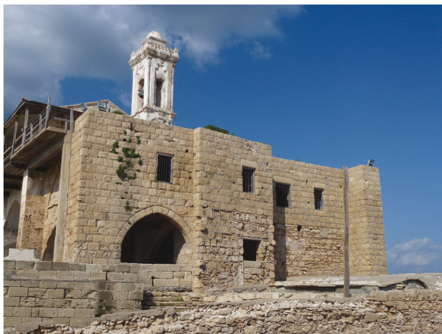
Εικ. 23. Ο ανατολικός τοίχος του κεντρικού συγκροτήματος όπου διακρίνονται οι δύο φάσεις κατασκευής του (Δ. Μυριανθεύς 2006).
